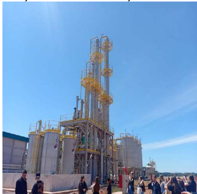
Ilustração 5 – Torre de destilação de etanol
